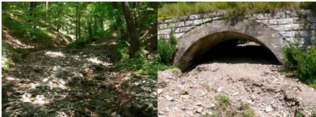
Železničný priepust pred Bujanovským tunelom zasypaný štrkom z erózne činnosti v lesoch (2010)
